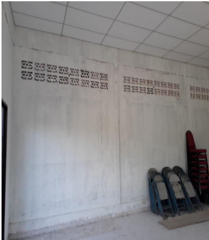
DINDING YANG PERLU DI 'PLASTER'
